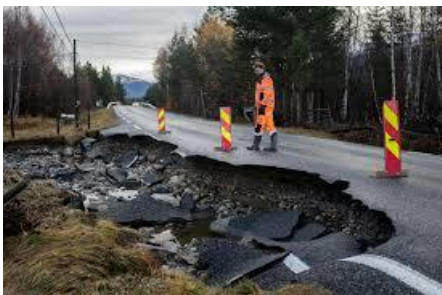
Skadet offentlig vei, p.g.a. styrtregn. vg.no.
